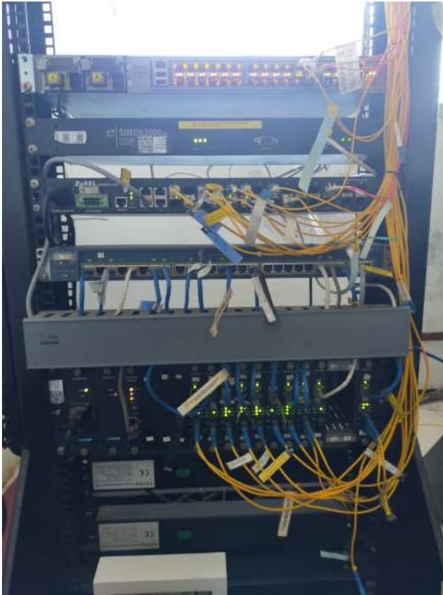
Gambar 4.6 Router waktu pekerjaan
