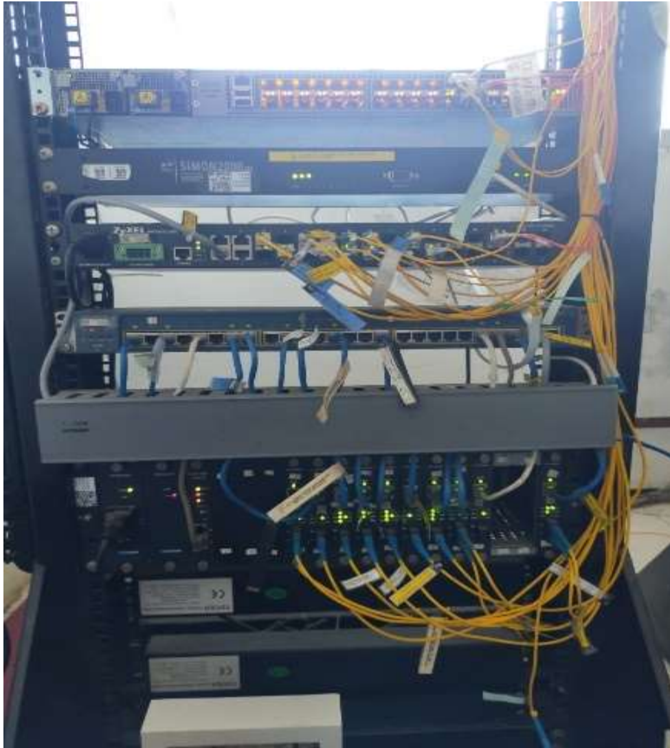
Gambar 4.18 Rack perangkat waktu pekerjaan
