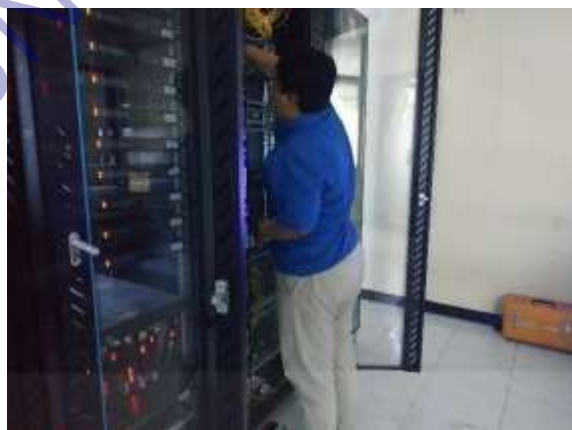
“Pemasangan alat baru ODP pada server”
